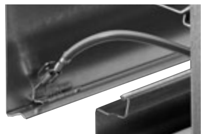
Заземление верхней крышки канала BRS
